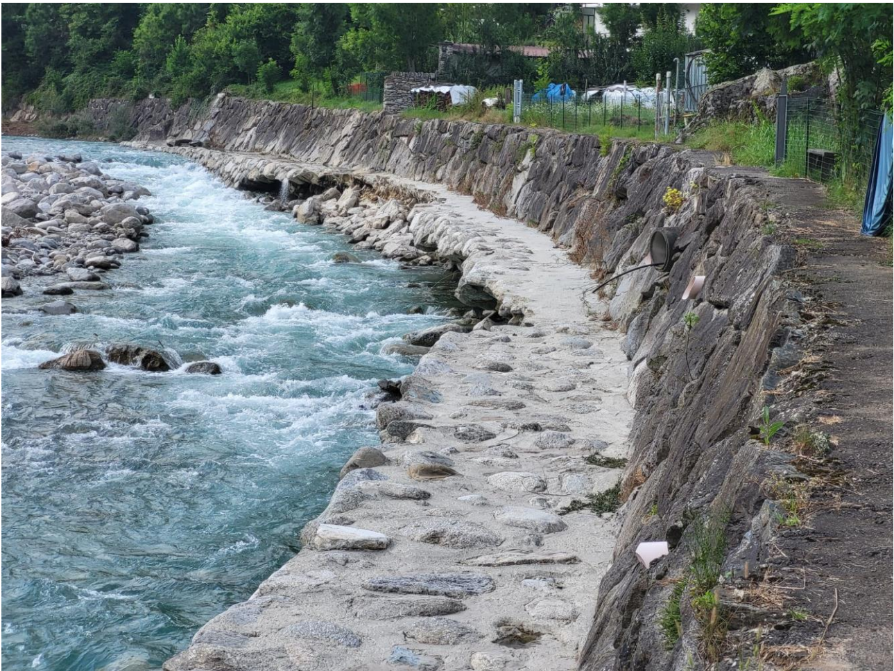
Foto 1 – Particolare della sottomurazione danneggiata
